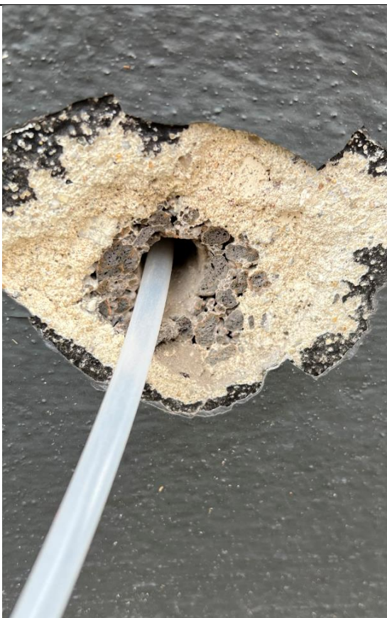
Foto 8: Eksempel på gennemboring af murværk indefra, O12. Bemærk at både fundament mod vest består af leca-blokke.
