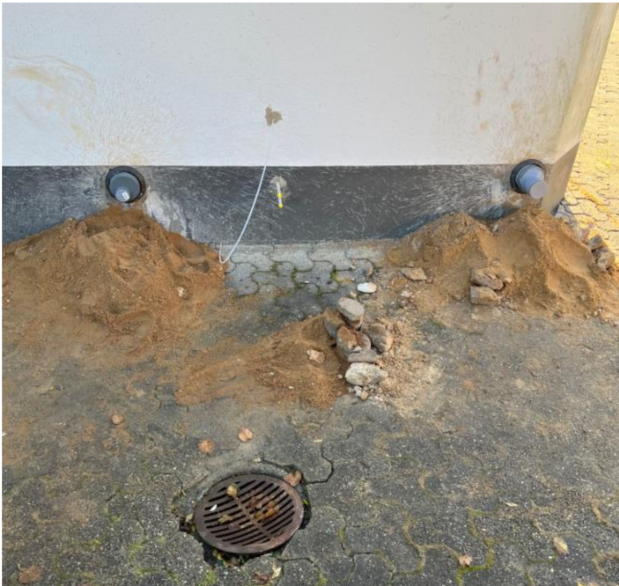
Figur 8: På billedet ses luftindtag til højre, og luft afkast til venstre. Billedet er taget fra nord.
